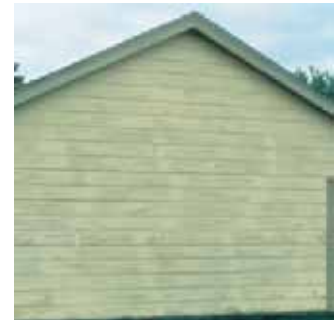
Fachada afectada por hongos cromógenos
